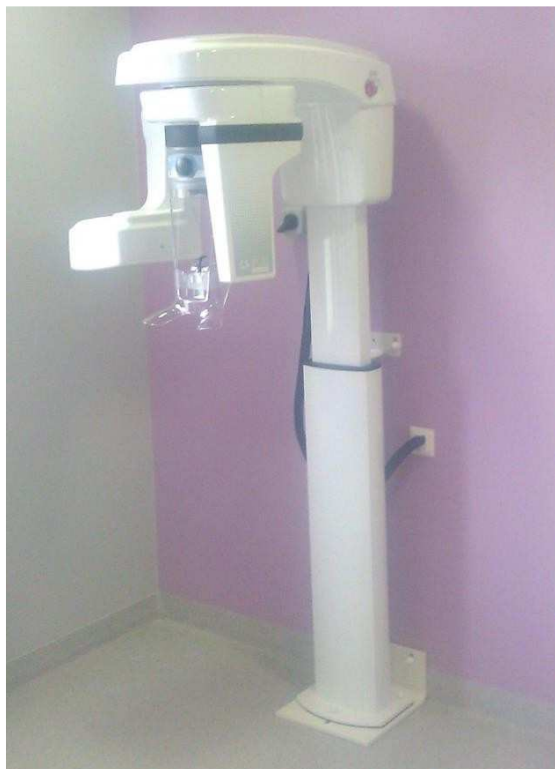
Rysunek 6 Urządzenie zamontowane na płyci montażowej
